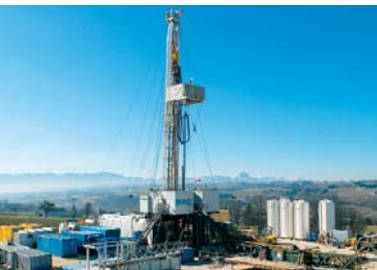
Aufwändig, aber ergiebig: Die Energie aus dem Erdinneren liefert Wärme und Strom.
