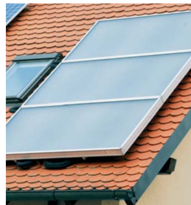
Ein Flachkollektor: Bei entsprechender Dimensionierung lassen sich 60% des jährlichen Warmwasserbedarfs decken.
