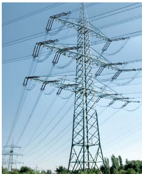
Energietransport: Ziel ist eine weitgehend verlustfreie Stromübertragung über weite Strecken.
